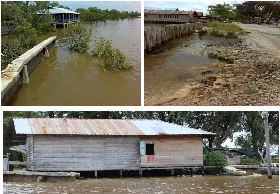
Gambar 7. Kehancuran turap (kiri), kehancuran jalan (kanan) dan rumah warga yang dulu HWL dibelakang rumahnya sekarang telah sampai di depan rumahnya (bawah)
