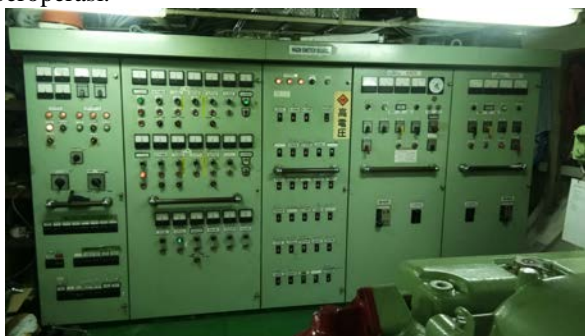
Gambar 2.2. Main switch board pada kapal
