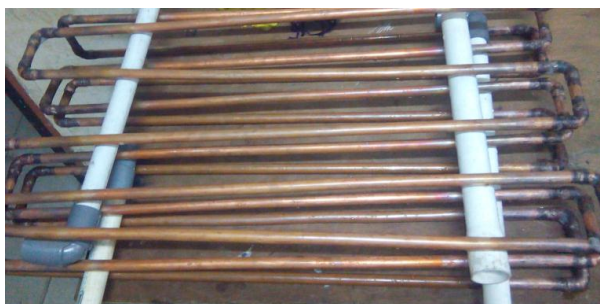
Gambar 4 Tube bagian dalam pada evaporator
