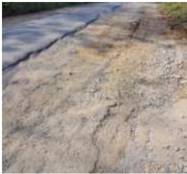
Gambar 1.1 Jalan Desa Dusun Tua Pelang
