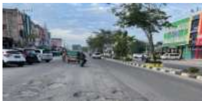
Gambar 1 Gambar Kerusakan di Jalan Sudirman, Kota Dumai
