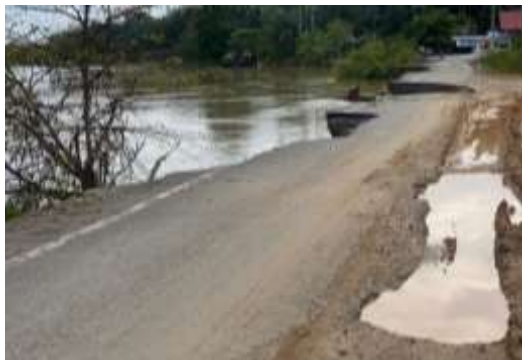
Gambar 1.1 Jalan Longsor di Desa Lembah Dusun Gading
